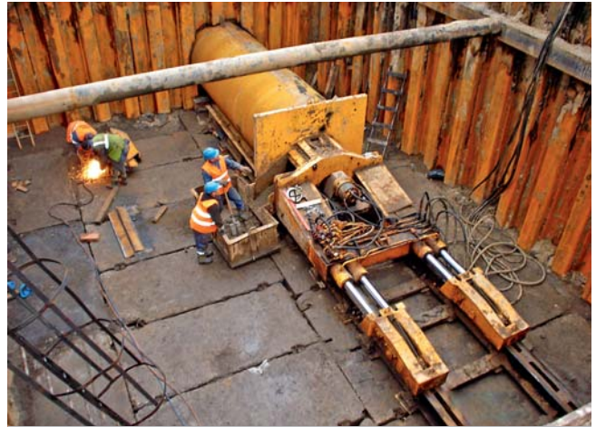
Fot. 4. Komora nadawcza umocniona grodzicami
